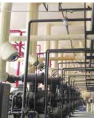
СЕМИНАР-ПРАКТИКУМ ПО ЭКСПЛУАТАЦИИ КРУПНЕЙШЕЙ В КИТАЕ ХОЛОДИЛЬНОЙ СИСТЕМЫ НА ОСНОВЕ \text{NH}_3/\text{CO}_2 , ОСНАЩЕННОЙ БЛОКАМИ ИЗ 16 КОМПРЕССОРОВ ДЛЯ \text{NH}_3 И ДЛЯ \text{CO}_2 . ФОТОГРАФИЯ ПРЕДОСТАВЛЕНА: КОМПАНИЯ «ЯНТАЙ МУН ГРУП КО. ЛТД.».
